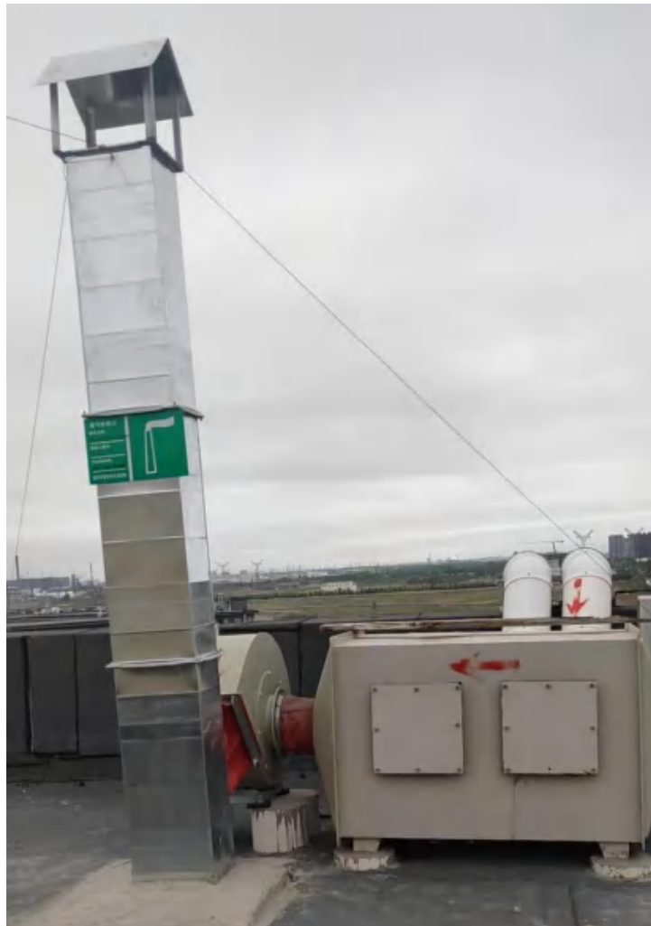
SDG（酸性废气吸附装置）+活性炭处理装置+排气筒 DA001
